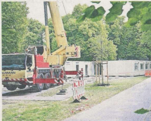
Das neue Containerdorf bietet Geflüchteten ebenso wie die Unterkunft am Hülsener Reepenweg im Vergleich zur Leichtbauhalle im Forstwald einen besseren Wetterschutz.
